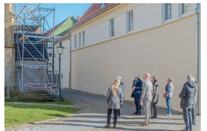
Das Außengerüst auf der Ostseite der St.-Dionysius-Kirche umschließt die denkmalgeschützte „Taufsakristei“. An der Verbindung des kleinen Fachwerkanbaus zum Hauptgebäude konnte lange Zeit Feuchtigkeit in das Gemäuer eindringen. Dort nahmen die Schäden vermutlich ihren Anfang.
