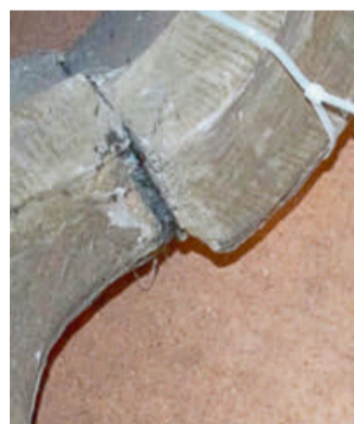
Diese Fuge in einem Spitzbogen-Ornament zeigt, dass das Mauerwerk um die Fenster dringend reparaturbedürftig ist.
