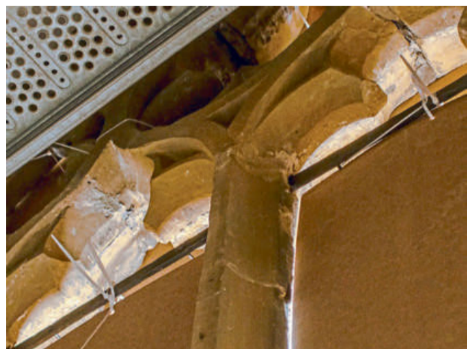
Die unscheinbaren horizontalen Eisenstangen stellen die Restauratoren vor ungeahnte Herausforderungen.
