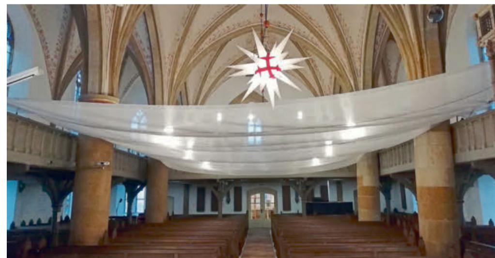
Um die Kirchenbesucher vor herabrieselndem Deckenputz zu schützen, ist ein Netz gespannt.
