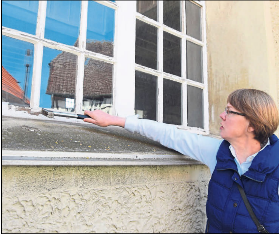
Brunhilde Meier macht die »Klopffprobe«. Die Fenster sind marode, dürfen aber wegen Denkmalschutz nicht ausgetauscht, sondern müssen aufwändig saniert werden. Fotos: Elke Bösch
