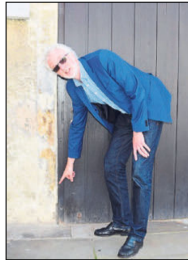
Pfarrer Udo Schulte zeigt: »Hier bröckelt der Putz.«
