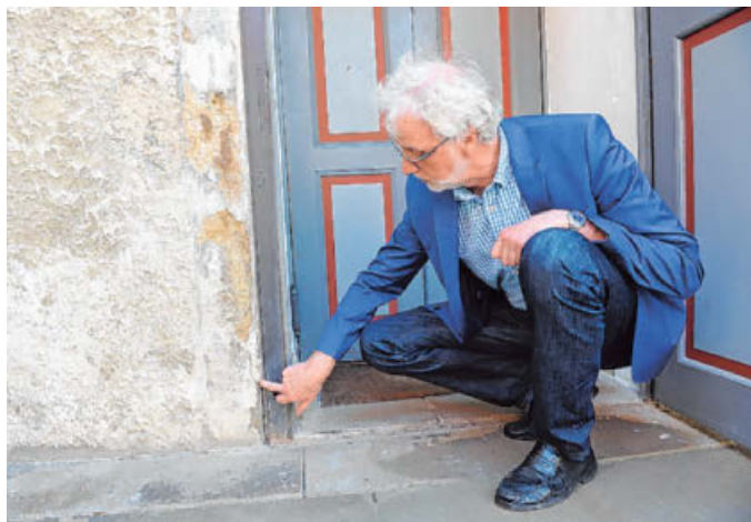
Beschädigt: Auch neben den Türen hat der Zahn der Zeit am Mauerwerk genagt, wie Pfarrer Udo Schulte zeigt.
