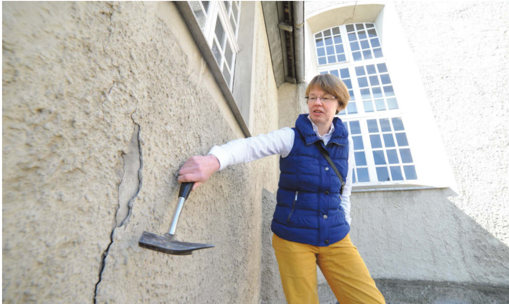
Hohle Stellen: Wenn Brunhilde Meier vorsichtig mit dem Hammer vorsichtig auf den Putz klopft, dann klingt das hohl. Ein großer Teil des Putzes werde wohl entfernt werden müssen, vermutet die Architektin.
