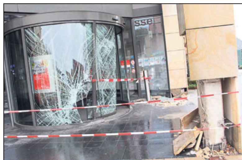
Verwüstet: Derzeit ist der Haupteingang der Sparkasse an der Osnabrücker Straße nicht mehr nutzbar. Foto: Viola Willmann
