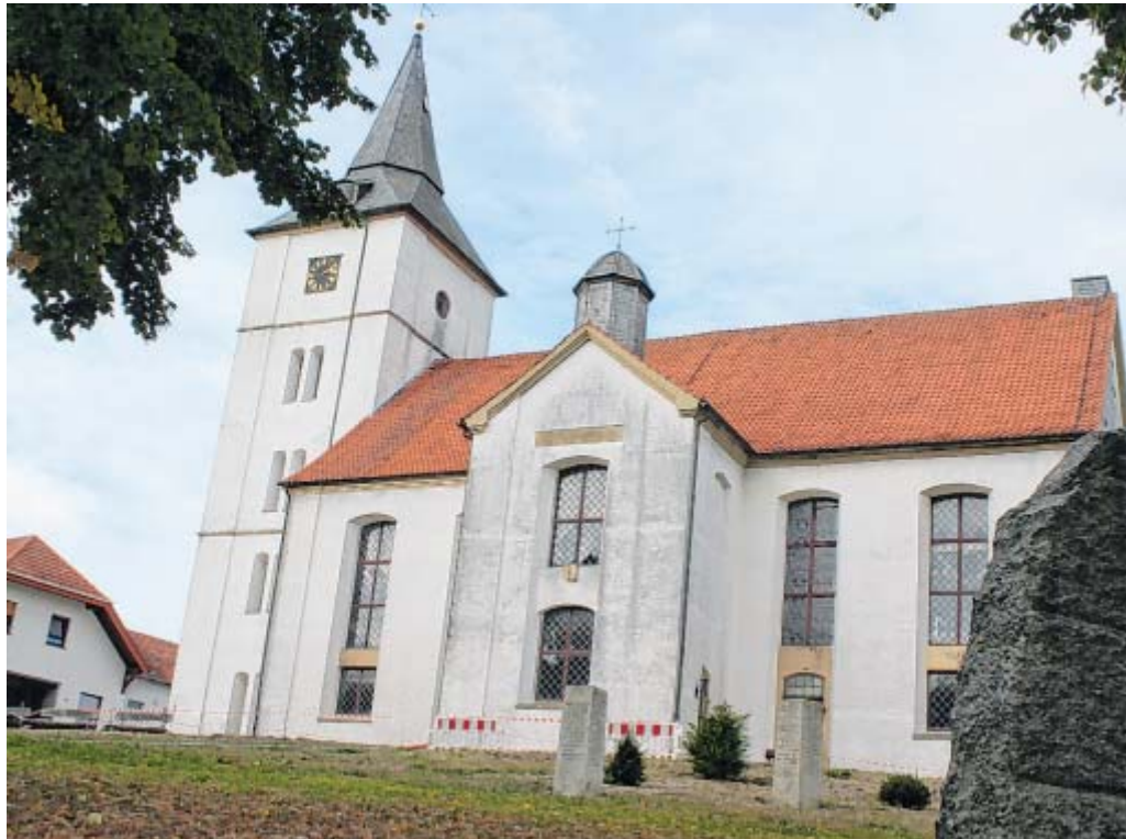
Es geht los: Mit den Arbeiten an den Fundamenten haben die Sanierungsmaßnahmen an der im frühen 19. Jahrhundert erbauten Wehdemer Kirche begonnen.
